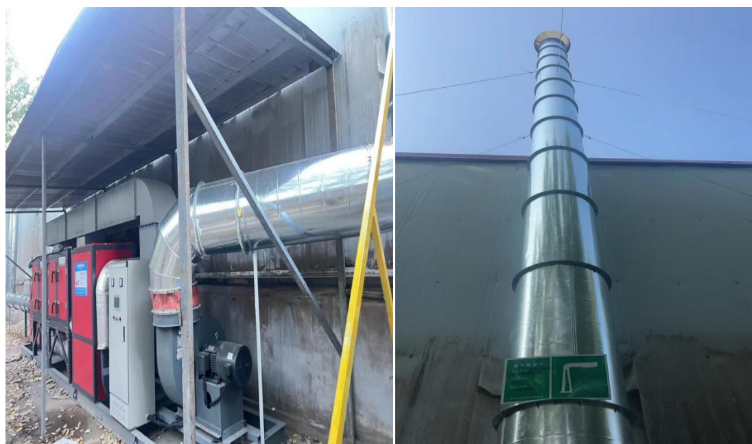
图 3-2 活性炭吸附/脱附+催化燃烧+15m 排气筒
